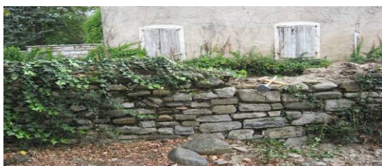
Mur de St Gladie avant rénovation...
